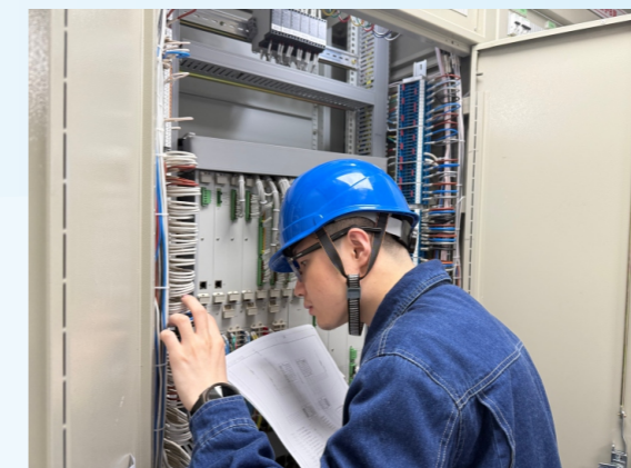
浙能金燃开展电气盘柜检查提升设备可靠性
