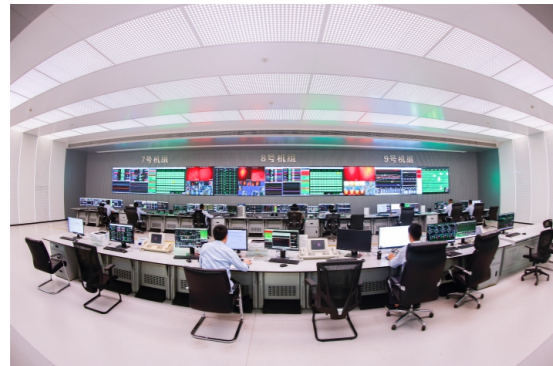
浙能嘉华四期9号机组集中控制室
