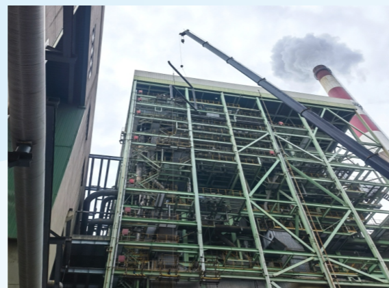
浙能长电完成机组灵活性改造提升调峰供热能力
