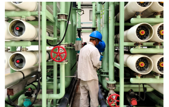
浙能温电维护汽机班员对化学制水设备 进行秋季安全大检查工作
