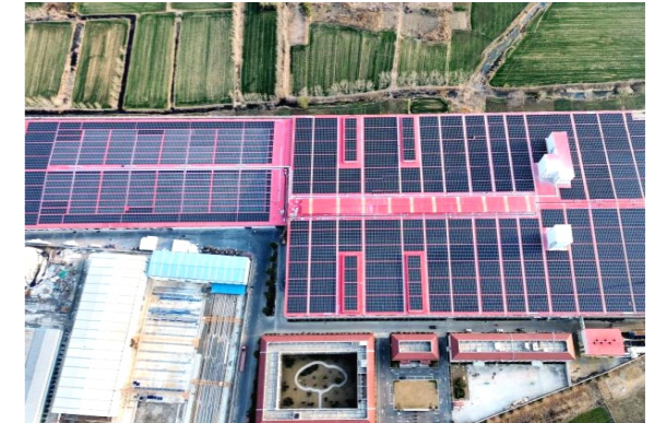
浙能北电江苏沃联光伏发电项目
