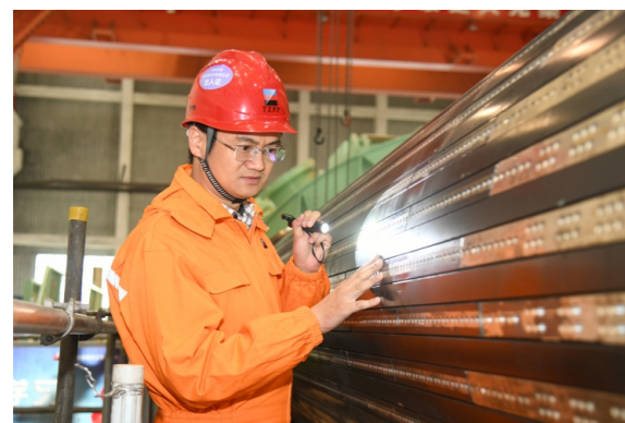
台州电厂 电气专工在检查发电机转子
